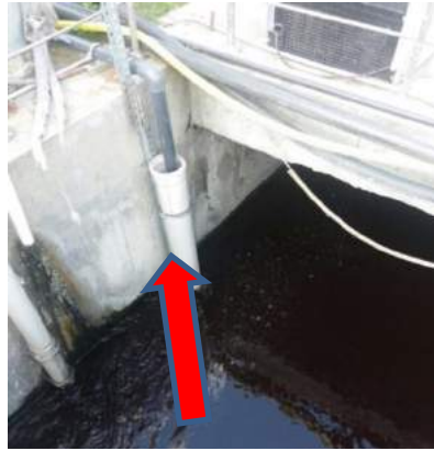
Şekil 14.37 İSKİ Ambarlı Biyolojik Atıksu Arıtma Tesisi son çöktürme çıkışı UF ham su girişi
