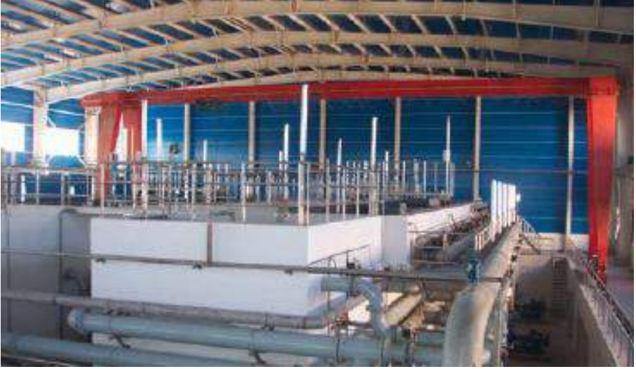
Şekil 14.30 Pekin'de Olimpiyat Parkında bulunan su geri kazanım tesisinin görüntüsü (EPA, 2012)
