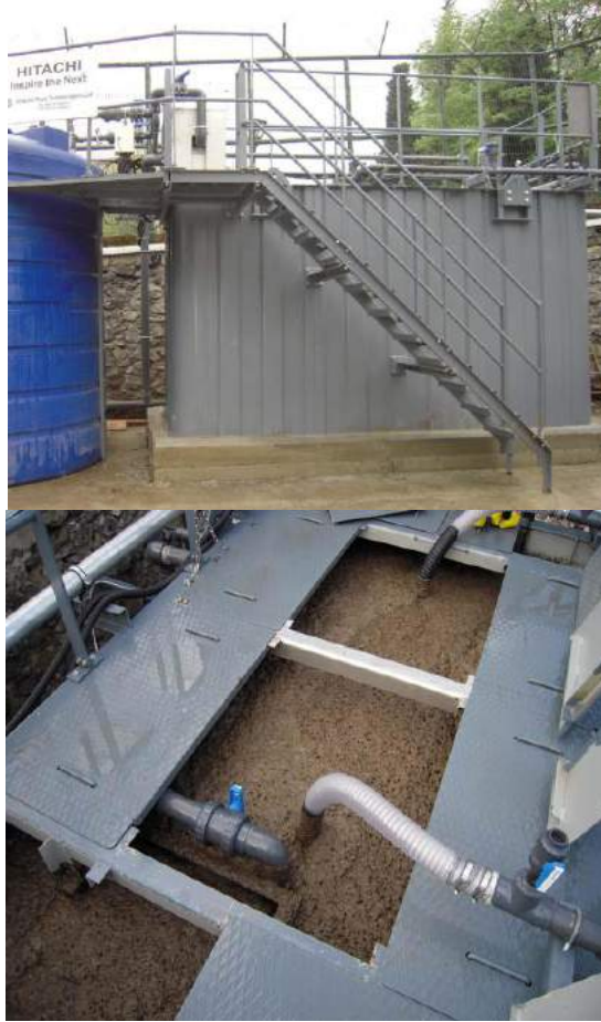
Şekil 13.9 İstanbul Hilton oteli gri su arıtma ünitesi görüntüleri (MBR, 2017)
