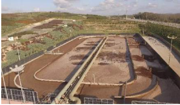
b) Kömürcüoda Sızıntı Suyu Arıtma Tesisi
